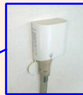
増設したガス栓の例
