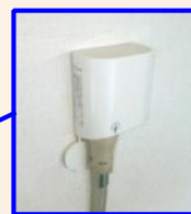
増設したガス栓の例
