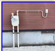
ガスメーターからの分岐の例
