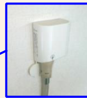
増設したガス栓の例
