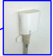
増設したガス栓の例
