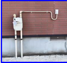
ガスメーターからの分岐の例
