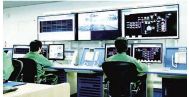
港工場コントロールセンター▲
