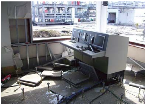
▲1階部分が水没・大破したバースセンター
