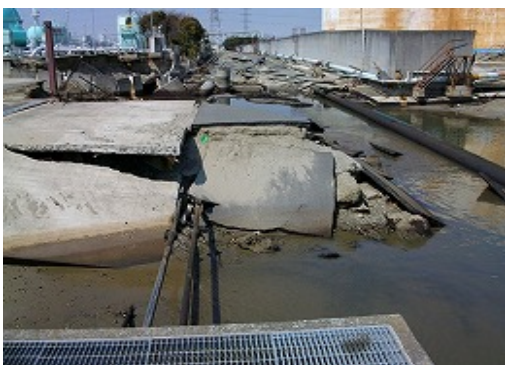
▲崩落した海水取水路
