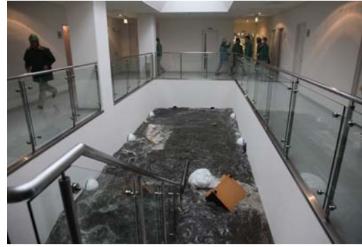
▲1階部分が完全に水没した港工場管理棟
