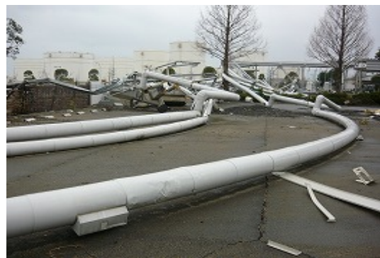
▲大きく曲がった配管やダクト管
